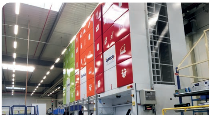
Wyposażenie w system przeciwpożarowy
