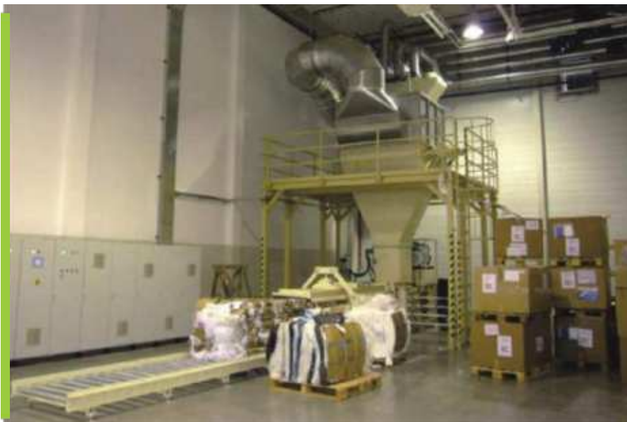
Separator ścinków z prasą belującą
